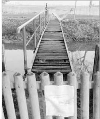
Seit Frühjahr 2016 ist die alte Brücke über das Sieltief gesperrt.
