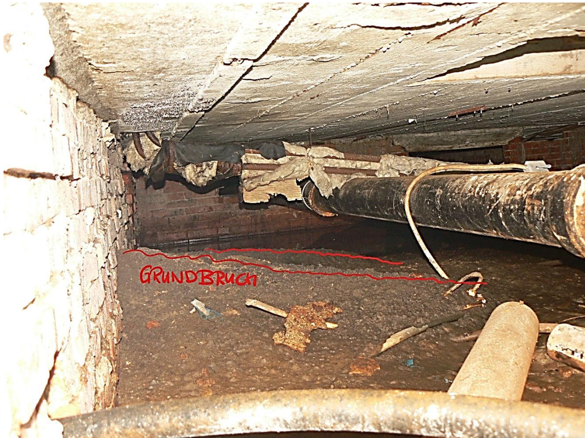
Abb. 16) Kriechkeller Grundbruch unter dem Fundament, Aufnahme vom 04.03.2021
