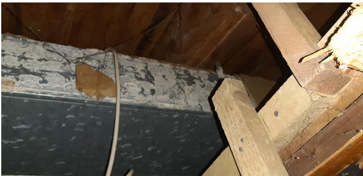
Abb. 51) Raum Nr.: 014, Achse H, Lüftungskanal
